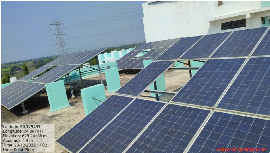
Fig.17.- Solar Rooftop Project
